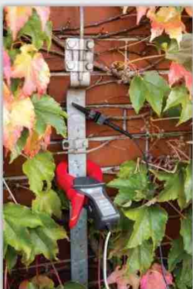
اندازه گیری مقاومت سیستم زمین بدون نیاز به جداسازی تجهیزات از سیستم زمین بکمک سه الکتروود و یک کلمپ (3P+CLAMP)
